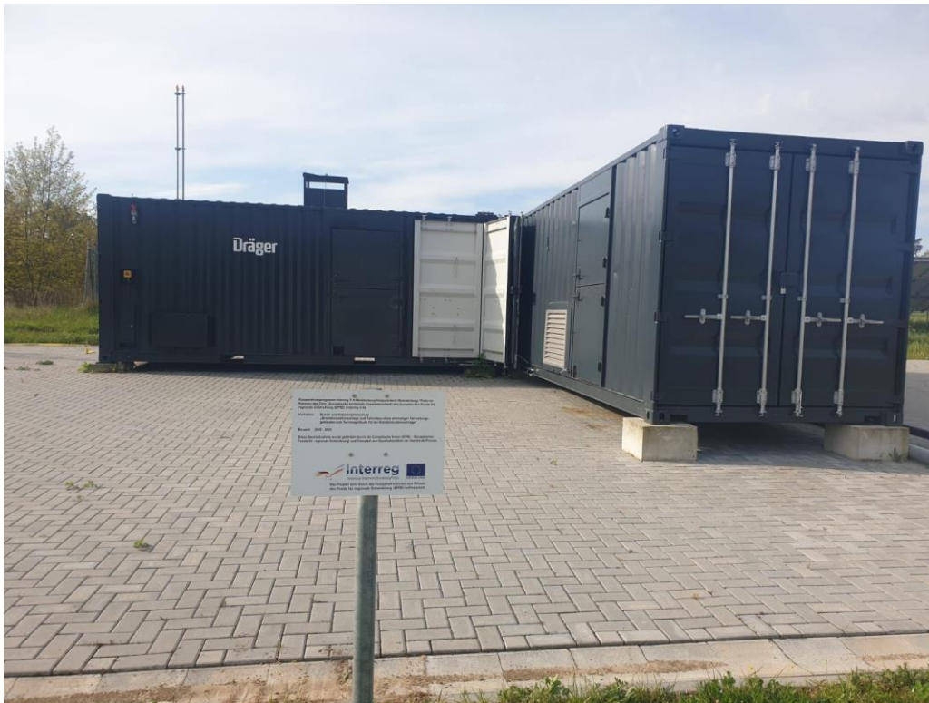
Bild 6) Brandcontainer am Standort in der Gemeinde Pinnow, Stadt Schwedt/Oder
